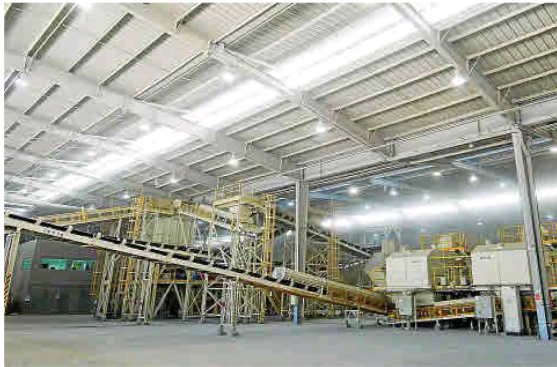
▲ La planta de áridos reciclados es como una cantera cubierta.
